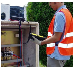
Inyección de señal con el transmisor IC1G-TX
